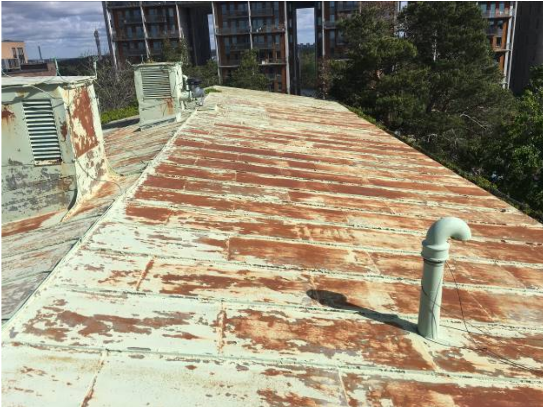
Plåttak sett söderifrån. Foto från besiktningsutlåtande, Jæger & J:son, maj 2019.
