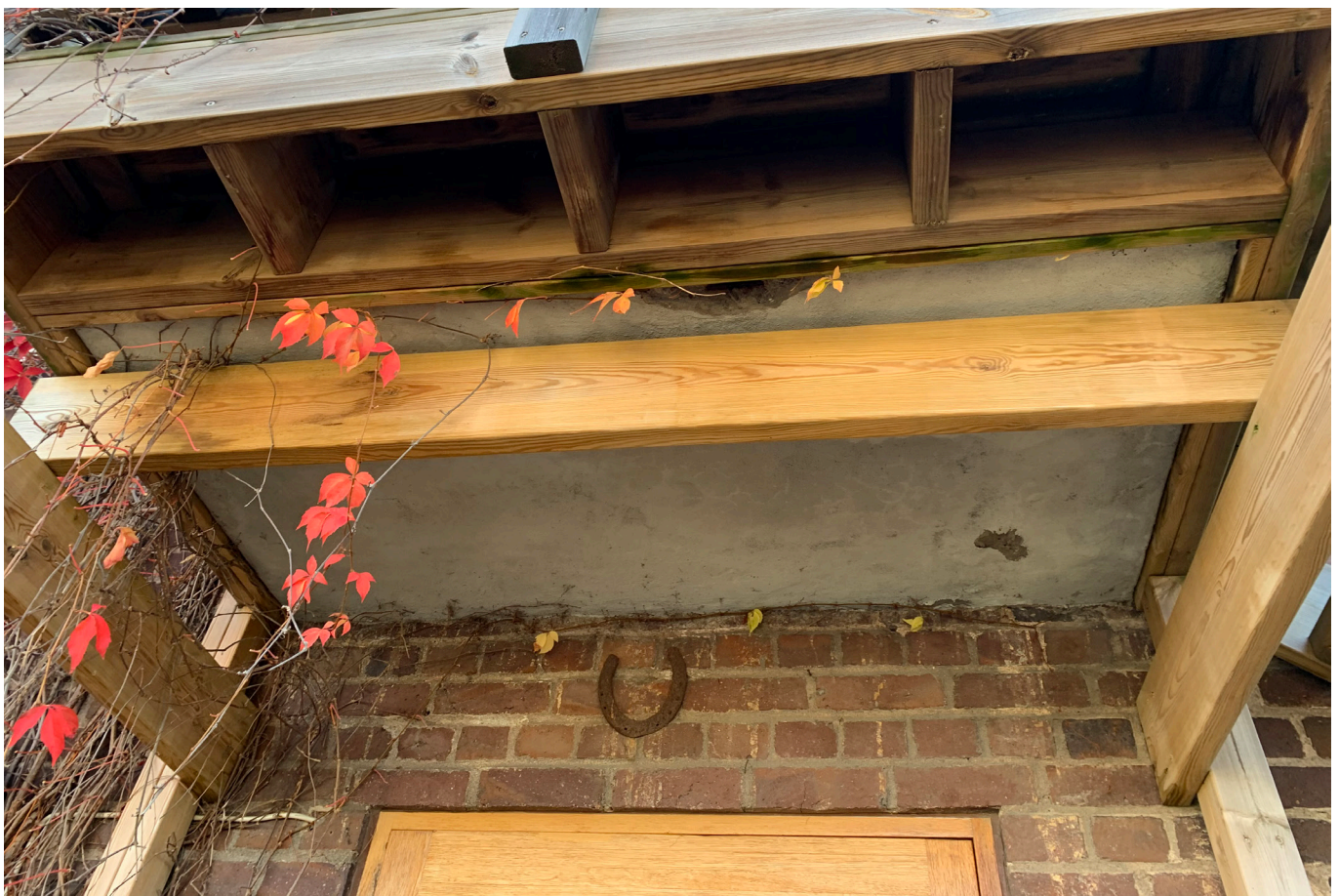
Balkongplatta ovan huvudentré delvis dold av senare tillkommen utrymningstrappa i trä som ska rivas. 2020.
