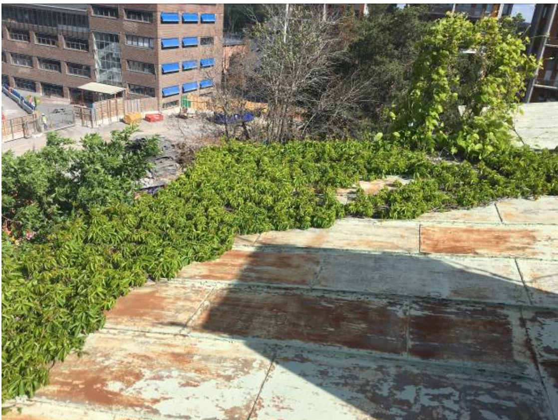
Plåttak vid trapphustillbyggnad. Foto från besiktningsutlåtande, Jæger & J:son, maj 2019.
