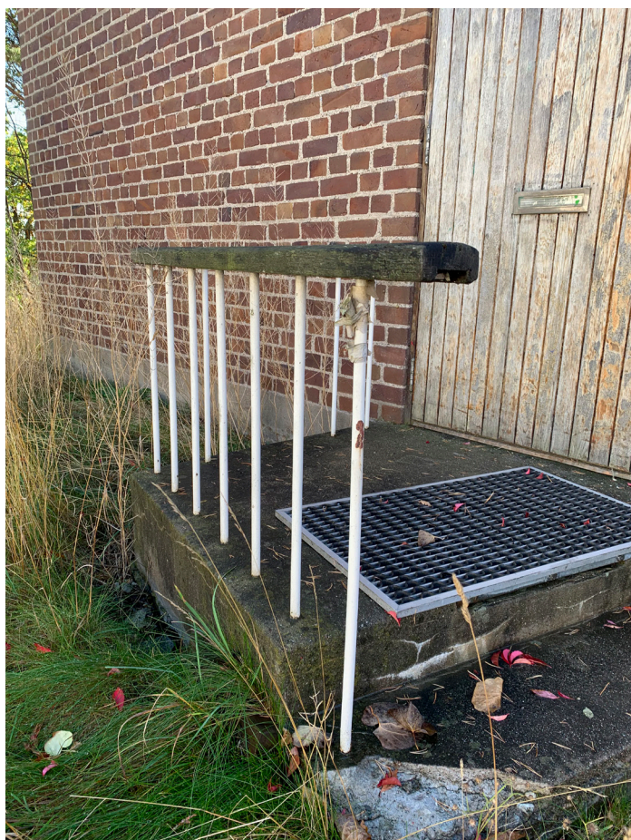
Betongtrappa med stålräcke vid trapphusentré. Yttre lager av fingjuten betong. Under löst liggande skrapgaller finns ett infällt skrapgaller av metall. 2020.
