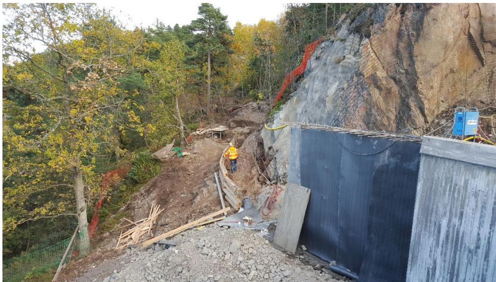
Bild 5. Vy från bron mot GC-vägen till Vikdalsvägen med formsättningen för stödmurarna mitt i bilden.
