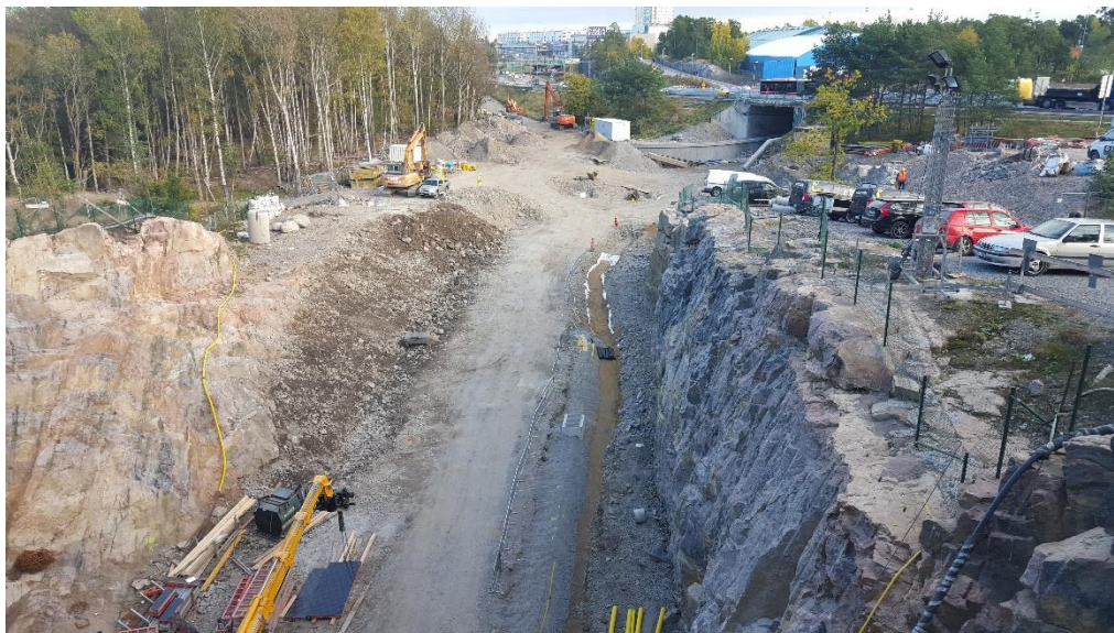
Bild 9. Kanalisering för el på västra sidan och iordningsställande av slänt på östra sidan efter rörläggning för VA.
