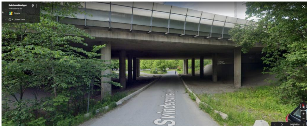
Figur 6. Underpassage som kan vara ekologiskt funktionell för olika djurarter. Förbättringsmöjligheter finns. Bild: Google Maps.
