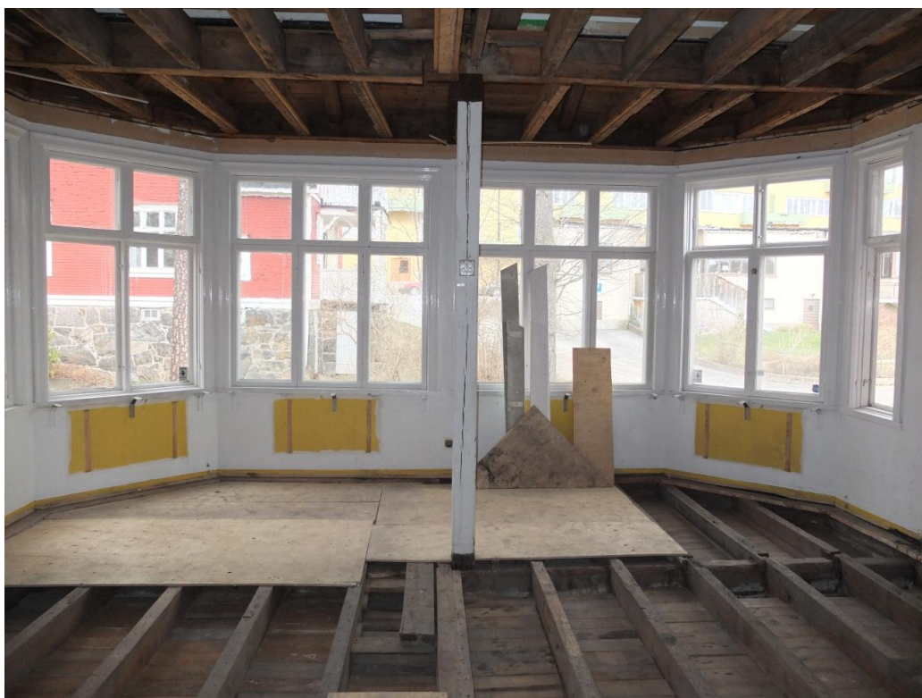
Glasverandan var ursprungligen delad. Golv, fyllning etc. har rivits p.g.a. en vattenskada.
