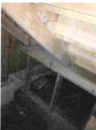
Stora delar av konstruktioner bakom och under läktaren är angripet av mögel
