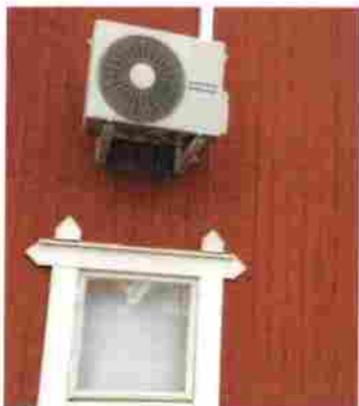
Värmepump orsakar fuktskador på väggen
