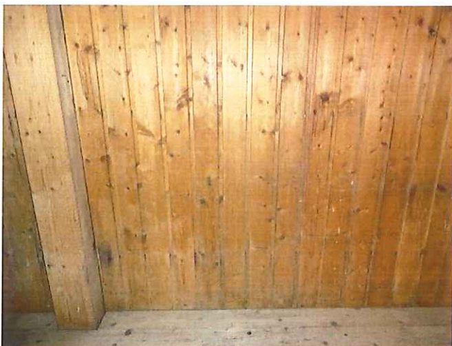
Bild 7, yttervägg i läktarnivå Fukt och mögelskador
