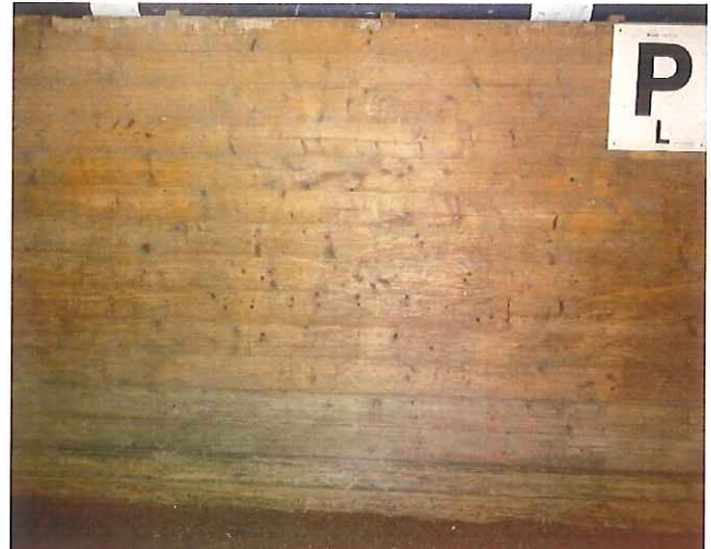
Bild 6, sargvägg på västra sidan Mögelskador på baksida vägg
