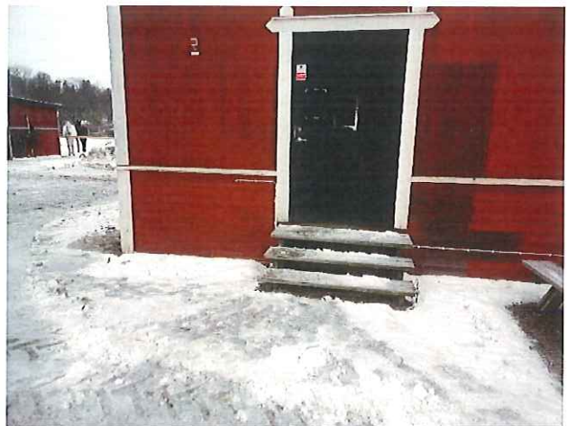
Bild 15, utrymningsdörr Räcke saknas, halkrisk
