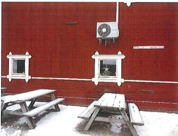
Bild 14, Luftvärmepump olämpligt placerad Fuktskador på väggpanel av kondens från värmepump
