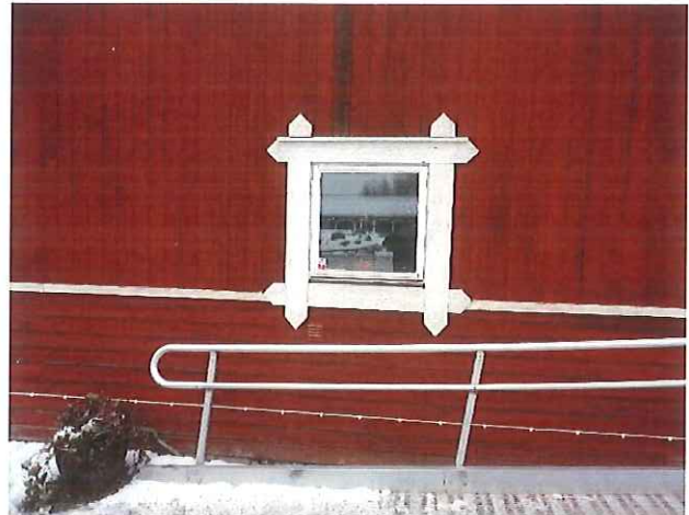
Bild 13, Fönster generellt Fönsterbleck saknas. (alla fönster)
