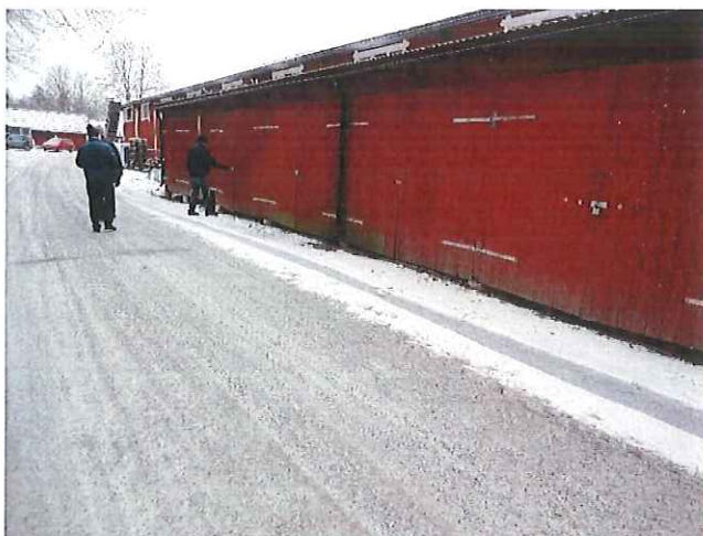
Bild 25, Förråd utanför norra fasaden Fukt- och mögelskador. Insidan ej tillgänglig
