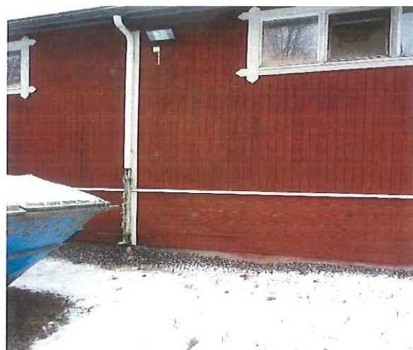
Bild 24, Norra fasaden Fruset stuprör
