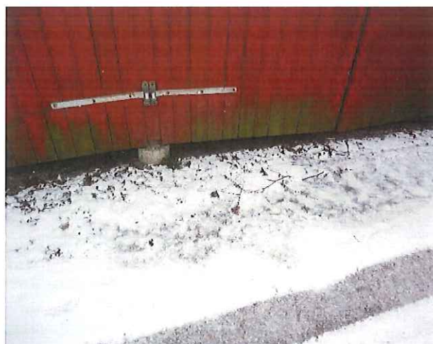
Bild 26, Förråd utanför norra fasaden Fukt- och mögelskador. Insidan ej tillgänglig
