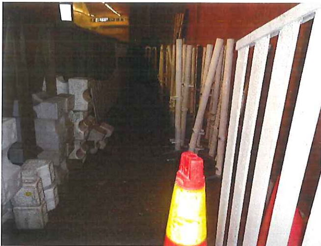
Bild 5, utrymme mellan yttervägg och lutande sarg Mögelskador i stor omfattning
