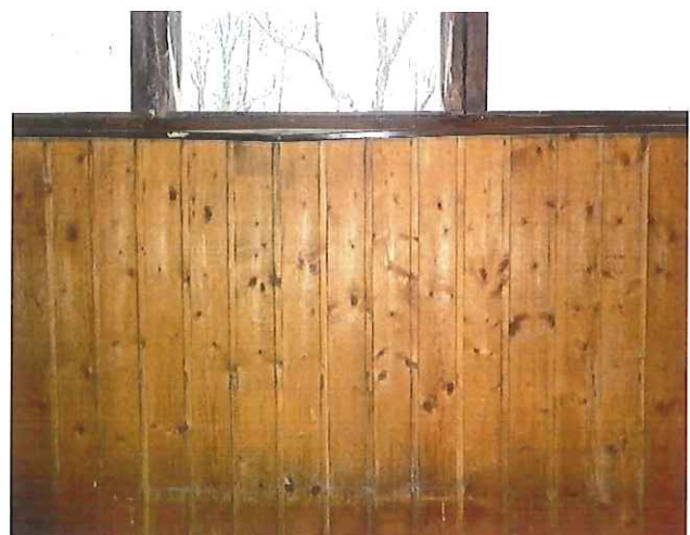
Bild 8, yttervägg i läktarnivå Fukt och mögelskador
