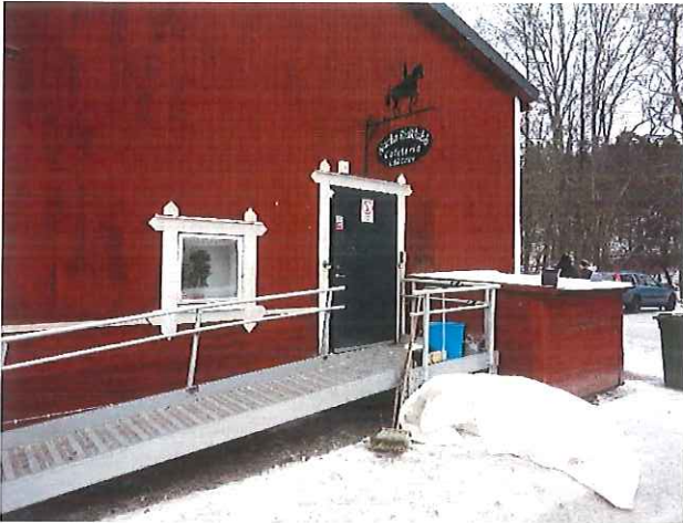
Bild 12, Södra gaveln, entre Risk för skada vid fall mot räckesändar.
