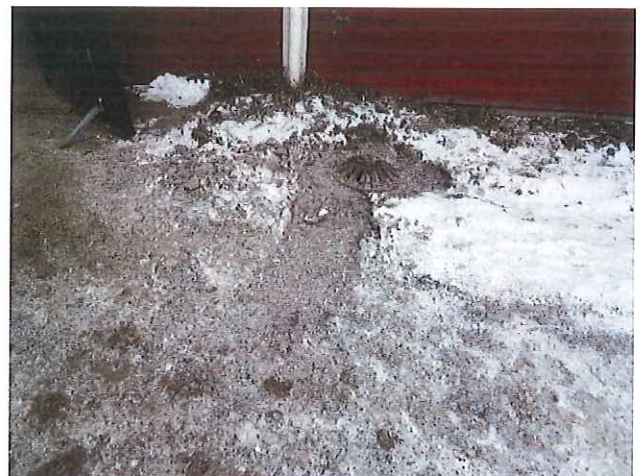
Bild 19, olämplig brunnsplacering (västra fasaden)
