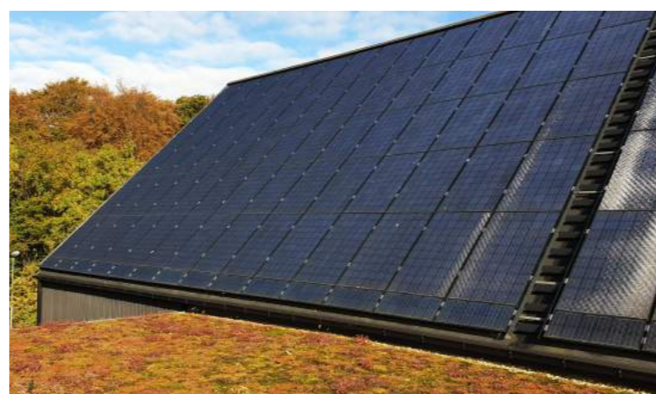
Väla gård, Helsingborg - solceller på tak
