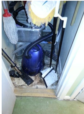
Foto 14 - Matta i städskrubb helt skadad.
