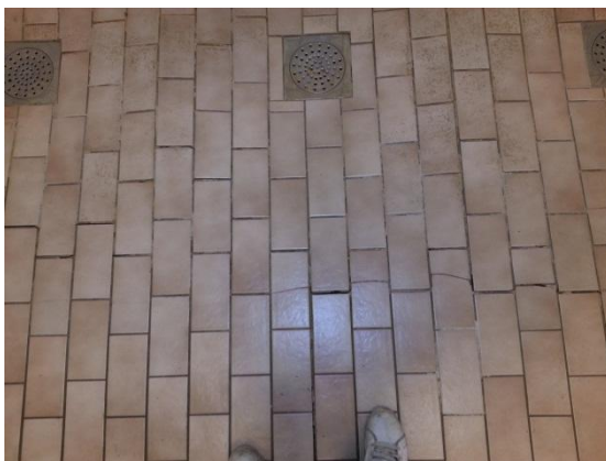
Foto 17 - Spricka i klinkergolv i duschrum.
