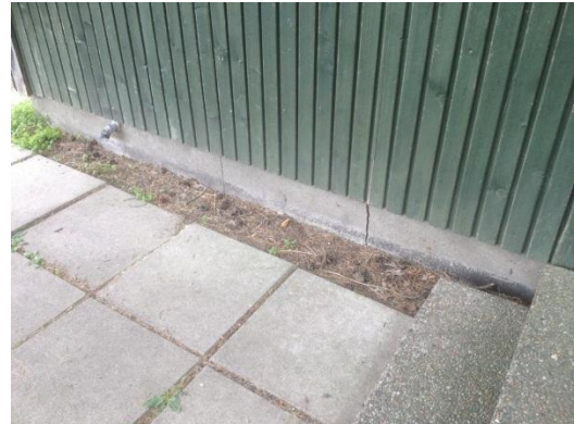
Foto 2 - Sprickbildning i sockel på gavel mot släggkastningsbanan.
