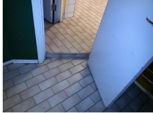
Foto 20 - Förlöjt golv i duschrum.
