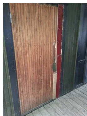
Foto 6 - Trasig dörr i passage.
