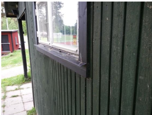
Foto 3 - Fönsterbleck i direktkontakt med fönsterfoder.
