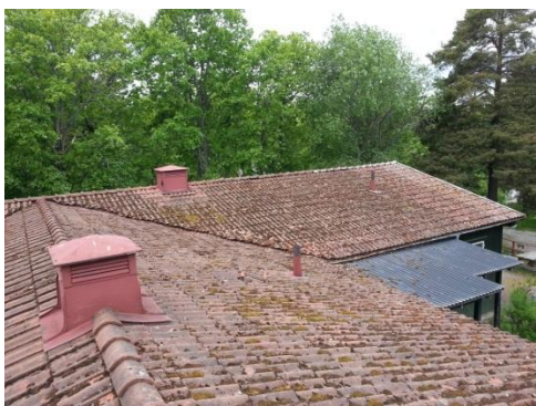
Foto 9 - Mosspåväxt på takpannor.
