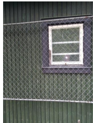
Foto 4 - Virkesskada i fönster.
