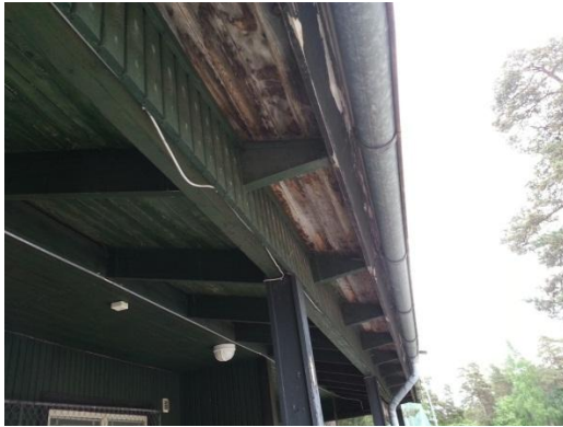
Foto 1 - Svartmögelangrepp på undersida råspont i takfot.
