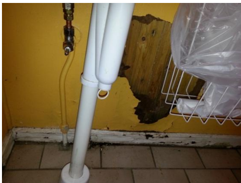
Foto 15 - Kraftigt fuktskadad skiljevägg mellan wc och omklädningsrum.
