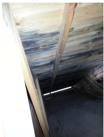
Foto 12 - Påväxt på råspont i kallvind.
