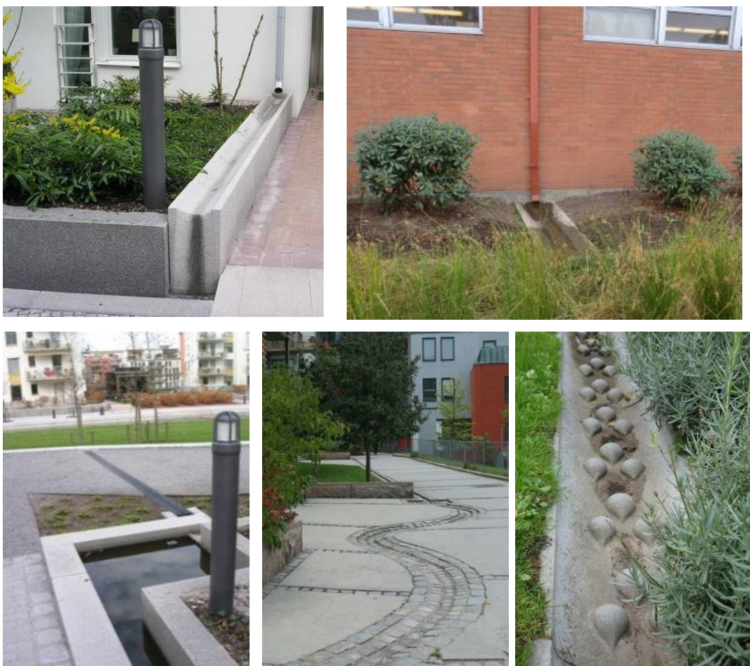
Figur 8. Övre bilderna ger exempel på stuprörutkastare som ansluter till rännor. Nedre bilderna visar olika typer av rännor.
