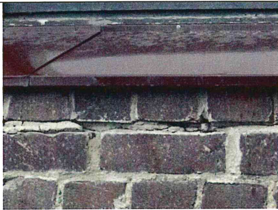
Bild 4. Skador på bruk under fönster på den norra fasadens låg del.
