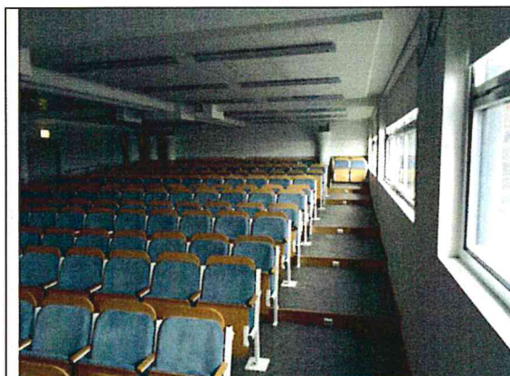
Bild 23. Uppstolpade golv i en föreläsningssal. Under golvet finns ett cirkulationsaggregat. Det uppstolpade golvet vilar på klinkerplattor.
