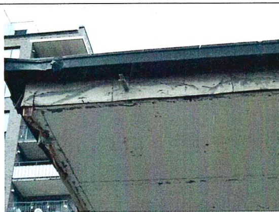
Bild 8. Påkörningsskada på skärmtaket i
