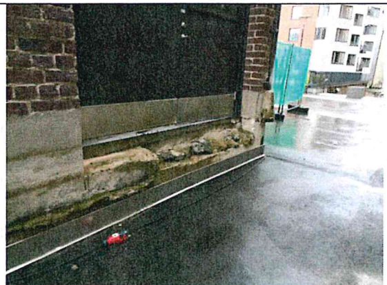
Bild 10. Sockeln på den norra fasaden har mindre skador.
