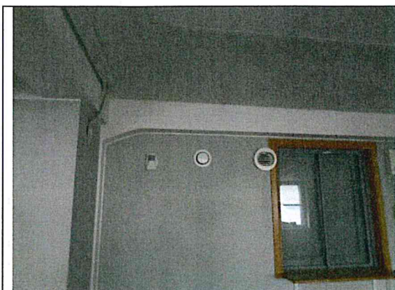
Bild 17. Avståndet mellan tilluftsdon och frånluftsdon är kort vilket medför risk för kortslutning vilket medför dålig ventilation och därmed risk för försämrad luftkvalitet.
