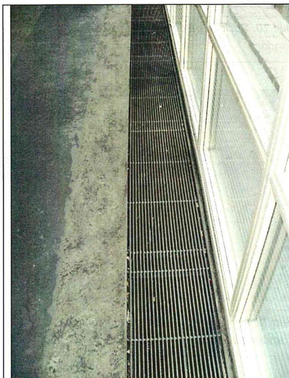
Bild 15. Värme distribution på övre plan delvis med radiatorer under galler i golv.
