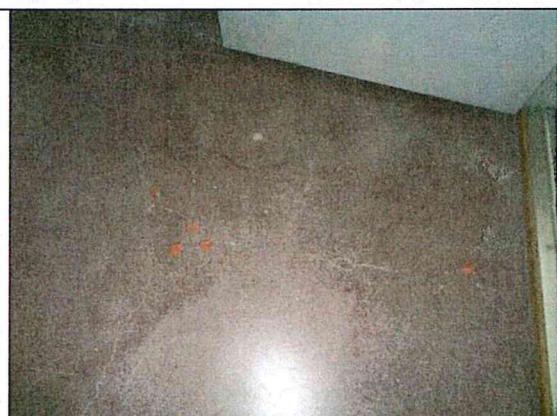
Bild 11. Sprickor i golvet på entrén på den norra delen av byggnaden.
