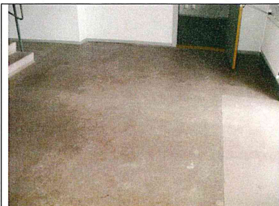
Bild 1. Golvet i huvudentrén på nordsidan av byggnaden är sprucket. Sannolikt sättningar.
