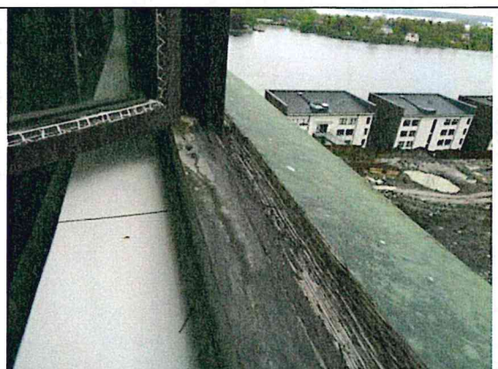
Bild 12. Färgen på botenstycket av fönsterkarmarna är sprucken och lös.
