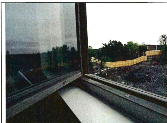
Bild 13. All färg på på fönstrets fönsterbåge har släpt.
