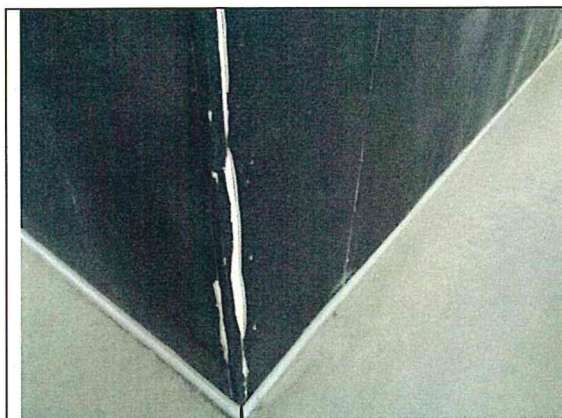
Bild 5. Skador på den "invändiga" fasaden på övreplanet.
