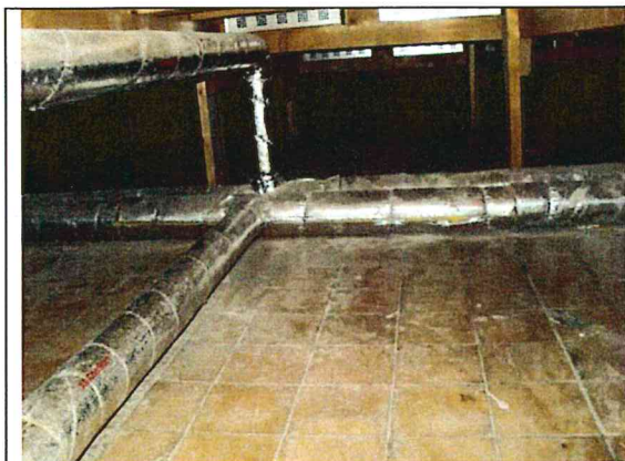
Bild 21. Under delar av de golv som är uppbyggda ligger gamla klinkergolv. Fogar och lim kan innehålla asbest.
