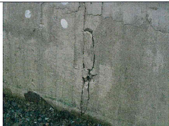
Bild 9. Sockeln på den södra fasaden har mindre skador.
