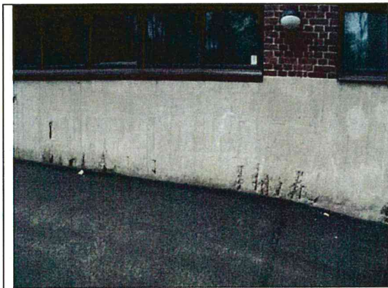
Bild 3. Skador på den ostliga fasaden.
