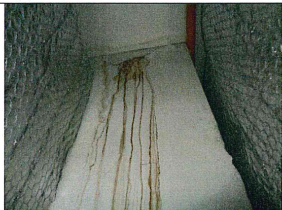
Bild 1. Övre delen av betongkonstruktionen i det västliga fläktrummet ser ut att vara sprucken samt att det funnits/finns någon form av vattenskada.
