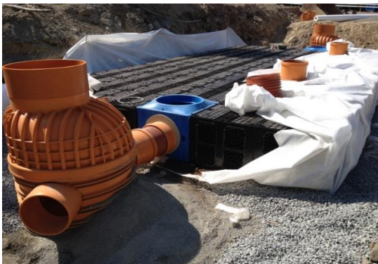
Fördröjningsmagasin av dagvattenkassetter.
