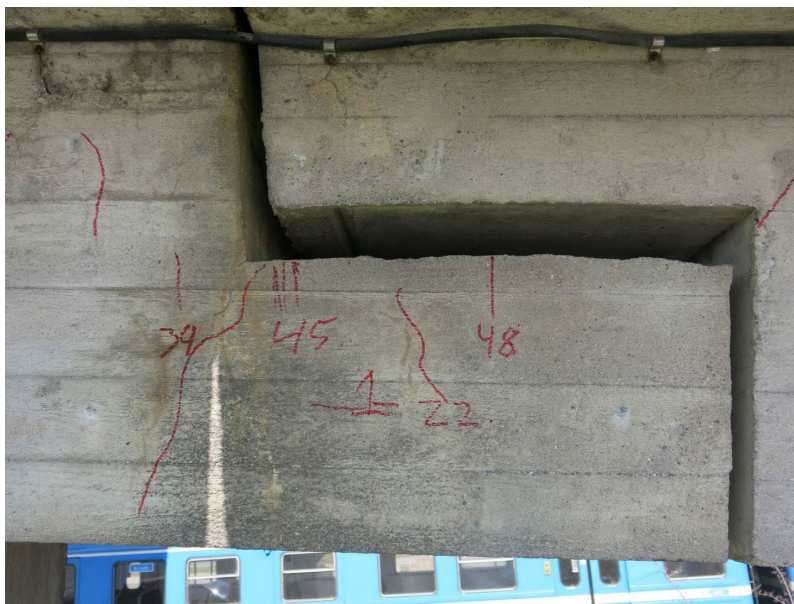
Figur 2: Detaljbild av det södra hakupplaget. De röda strecken indikerar synliga sprickor i betongytan.
