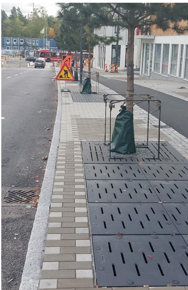
Figur 8. Övre bilden genomskäring av täckt regnbädd. Nedre bilden anlagd täckt regnbädd med träd i Vikdalsvägen Nacka. Inloppsbrunn från gatan och GC-väg synns på bilden.
