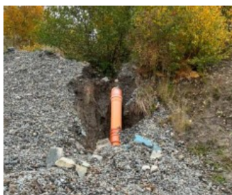
Figur 25. Erosion kring en ledning öster om område 2.
