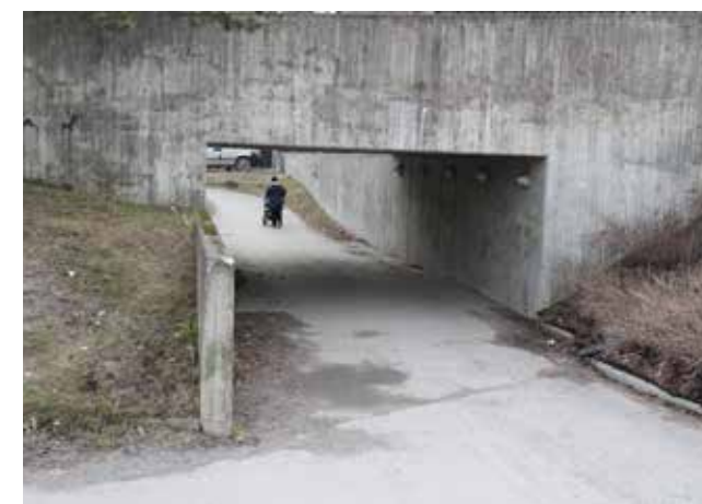
Gång- och cykeltunnel vid panncentralen
