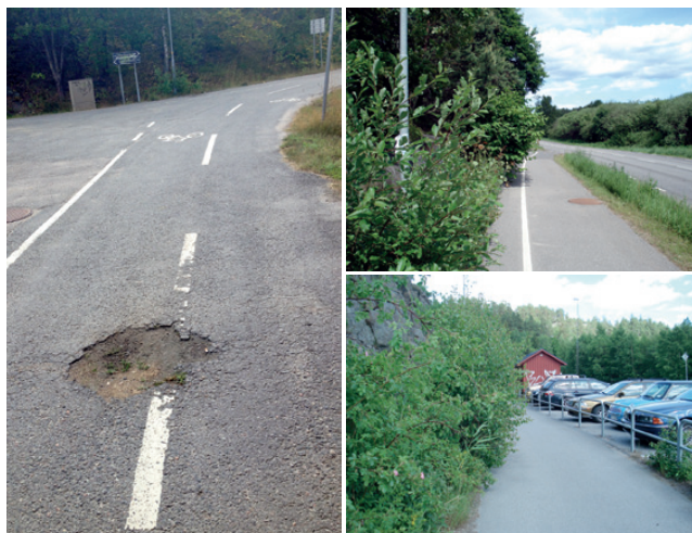
Beläggningsskada och överhängande vegetation.
