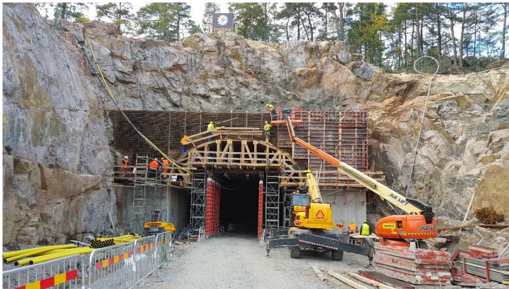
Bild 8. Förberedelser för sista gjutningen av portal för södra förskärningen som kläs med gabionmur.
