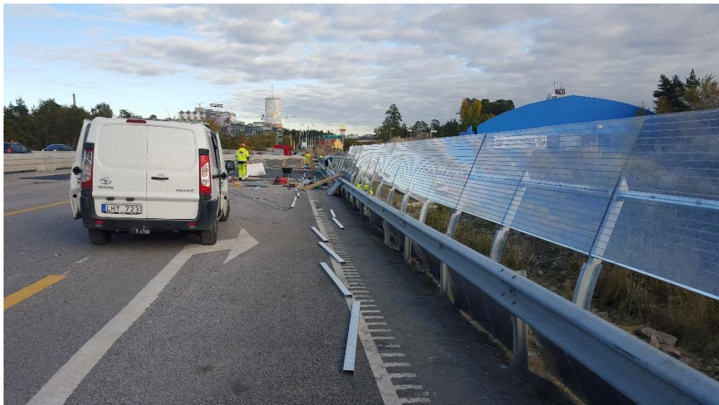
Bild 10. Ny bullerskärm i direkt anslutning till Värmdöleden vid skol- och idrottsområdet.
