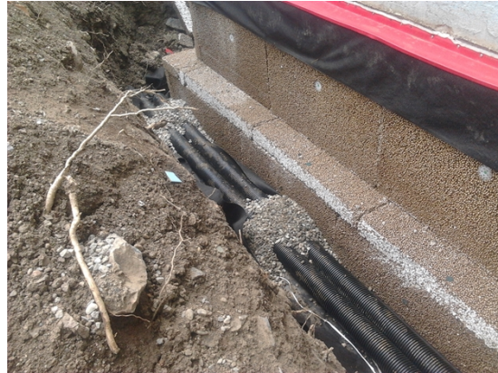
Bild 3. Dubbladräneringsrör runt huset
