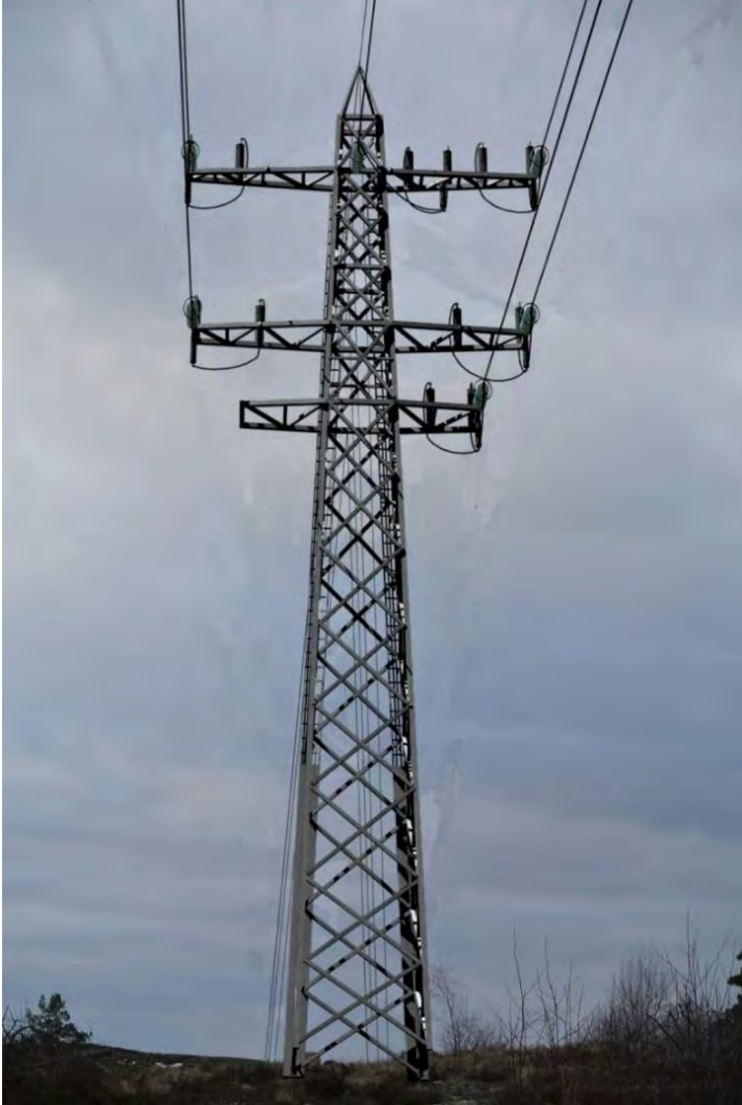
Figur 8. Exempel på kabelstolpe
