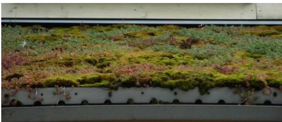
Figur 16 Exempel på ett anlagt sedumtak i Augustenborg (Sweco).
