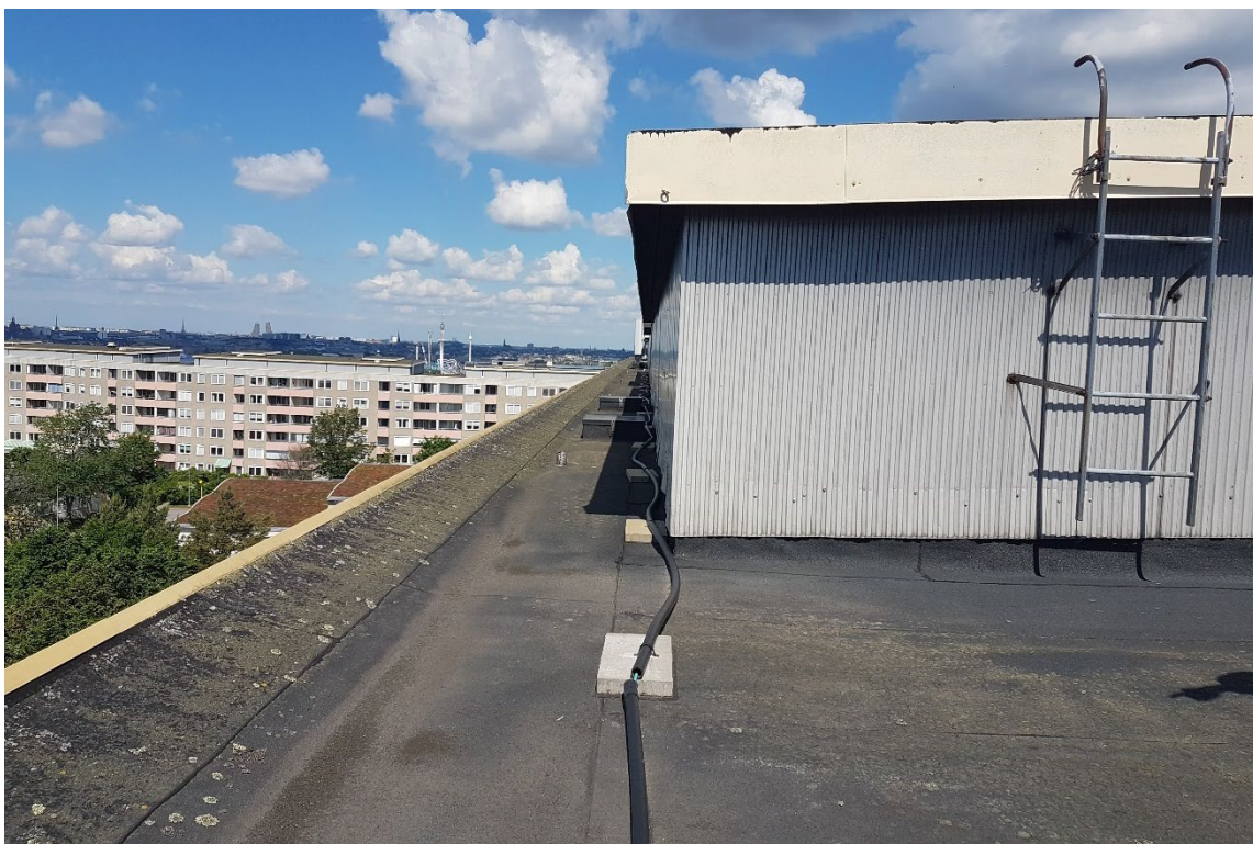
Mot gården är uppbyggnaderna indragna och lägre. Vinden på bilden har ursprunglig plåtpanel.
