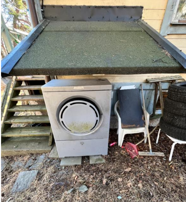
Figure 4 Luftvattenvärmepump utedel i byggnaden
