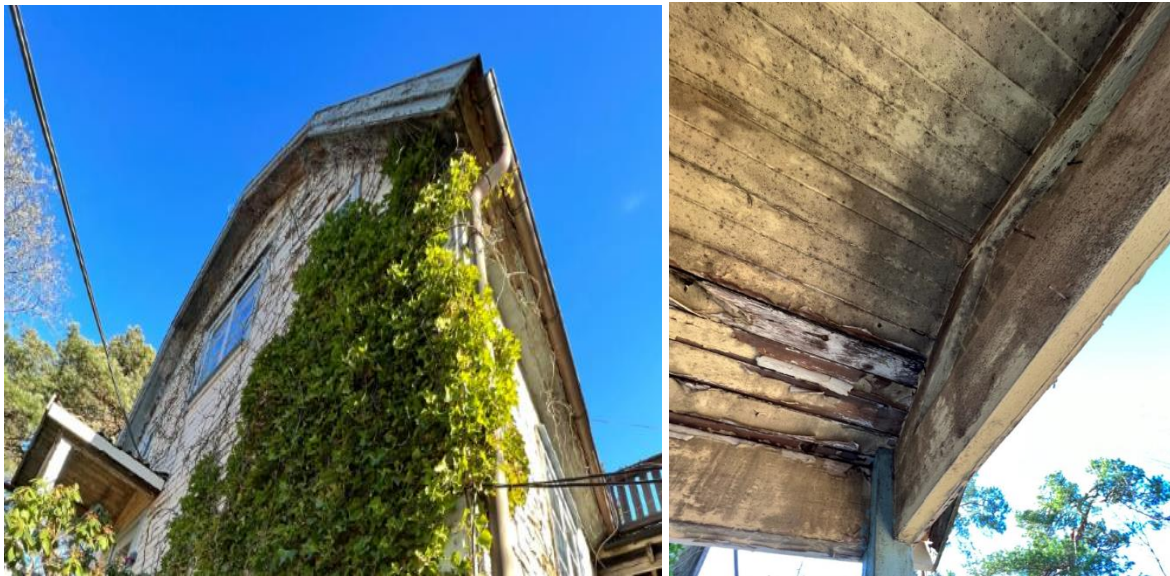
Figure 1 Takfot med tydliga tecken på svartmögelpåväxt och bör åtgärdas omgående, dessutom stora färgflagor och rötskador på träpanel
