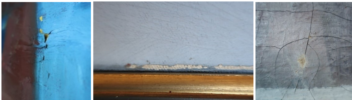
Från vänster sett visas exempel på färgflagor, färgbortfall och sprickbildningar i måleriskiktet.
