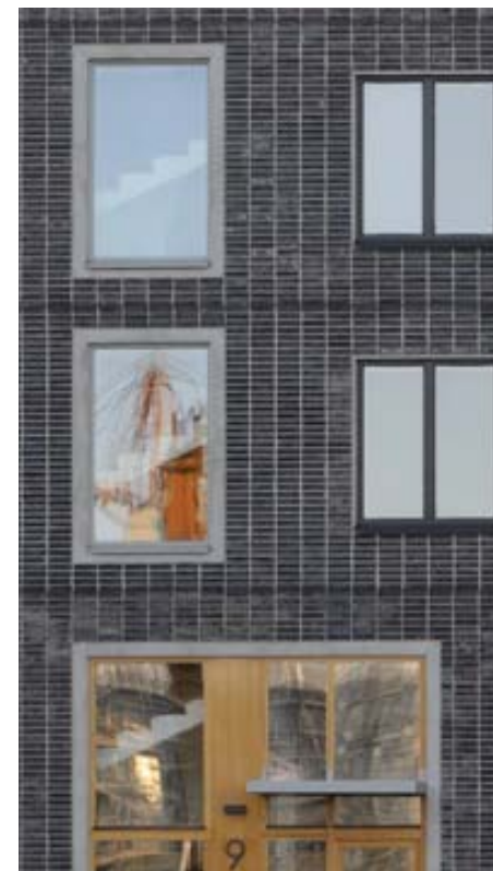
Ram av betong runt entré och trapphusfönster vid klinker fasad
