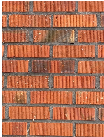
Tegelfasaden är släckig, vilket kan bero på teglets naturliga utseende eller vara någon slags påväxt.
