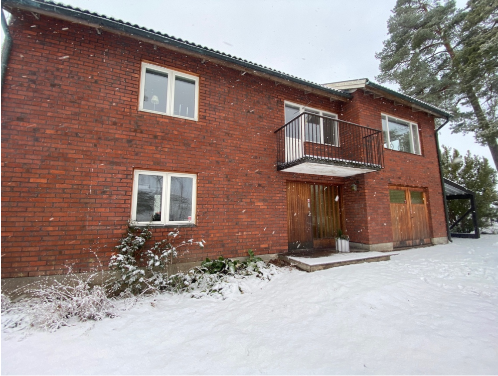
Baggensudde 9_4 framsida. De två fönstren till höger är utbyggda till aluminiumfönster. Övriga fönster och dörrar är original.
