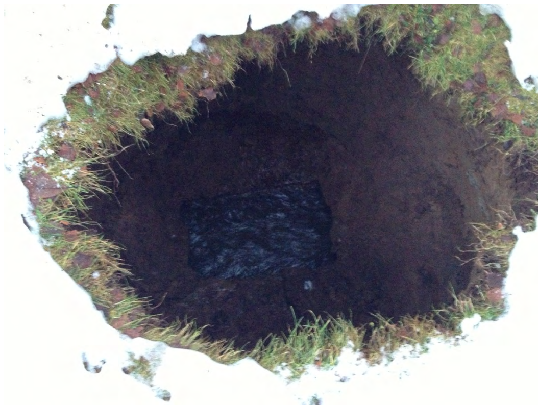
Bild 2: Slukhål som bildades i samband med en ledningskollaps.
