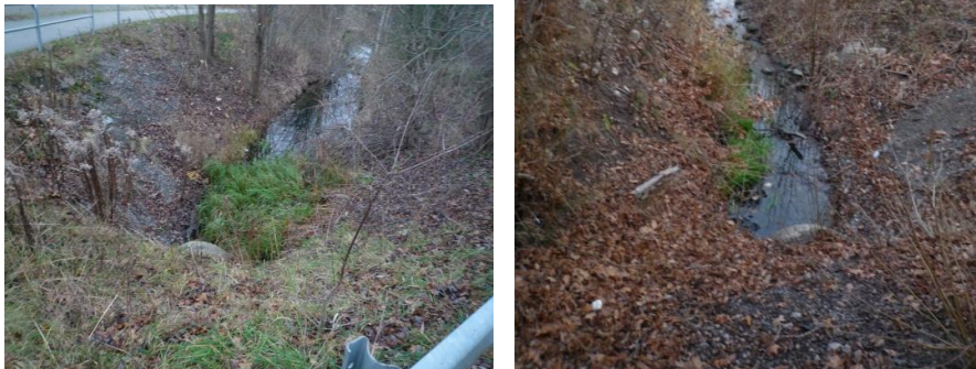
Figur 2-7 Inlopp och utlopp till kulvert under Kompassvägen.
