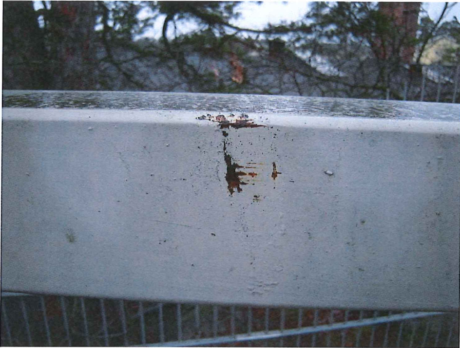
Skada i färgsystemet där korrosion påbörjats.
