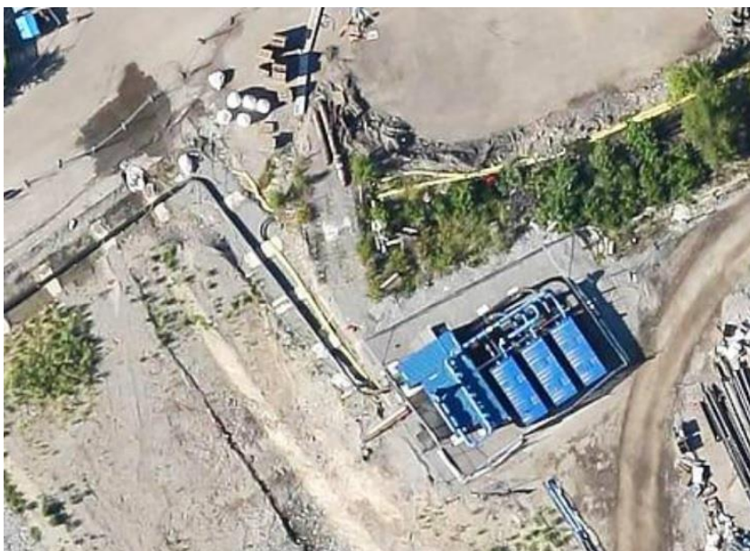
Figur 14, Tillfällig sopsugsterminal Norra Djurgårdsstaden, modulbyggd med staket runt.
