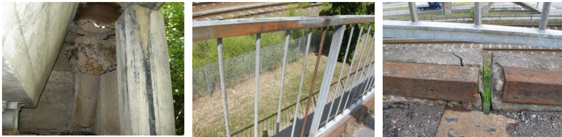
Figur 6: (vänster bild) Gravrost på ytavlopp som är ur sitt läge, (mittbild) Korrosionsskador på staketgrind, (höger bild) Skador i kantbalk och fog.
