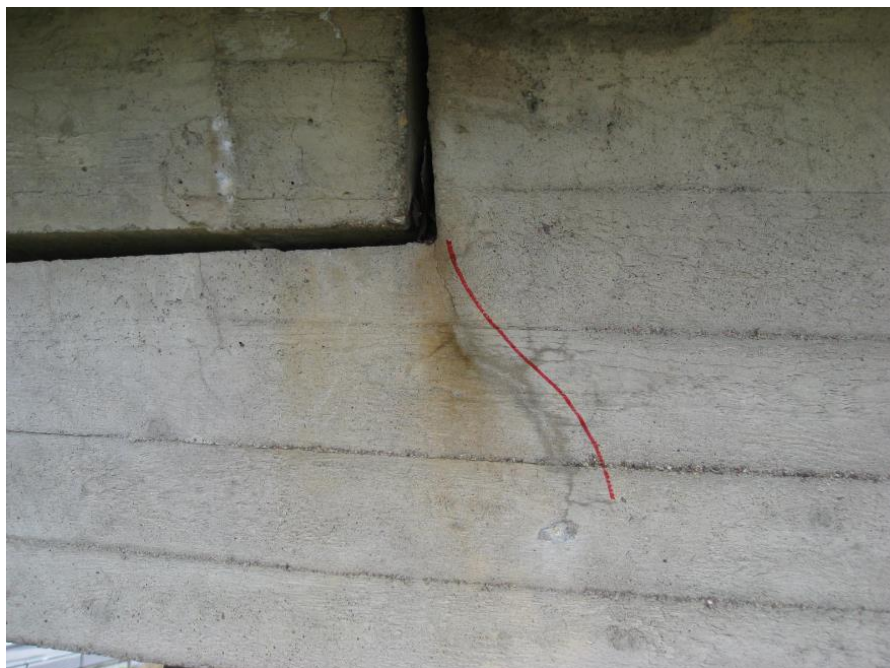
Figur 5: Skjuvspricka i hakupplag i överbyggnad över Saltsjöbanans spårområde.
