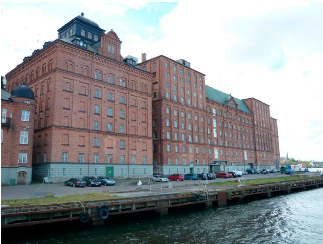
Kajen idag. Den yttre betongkajen är i dåligt skick och måste förstärkas.
