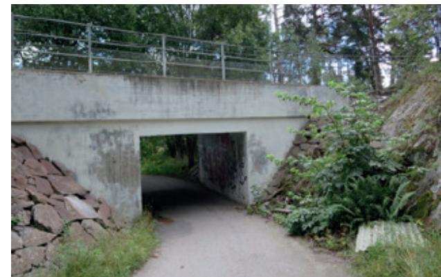
En trång gångtunnel vid Igelboda skola. Brant lutning och kurva ger dålig sikt och risk för otrygghet. Foto: WSP.
