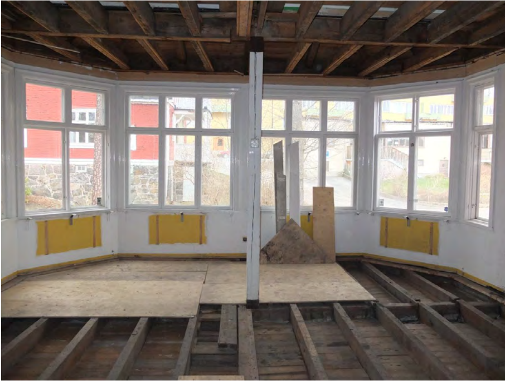
Glasverandan var ursprungligen delad. Golv, fyllning etc. har rivits p.g.a. en vattenskada.
