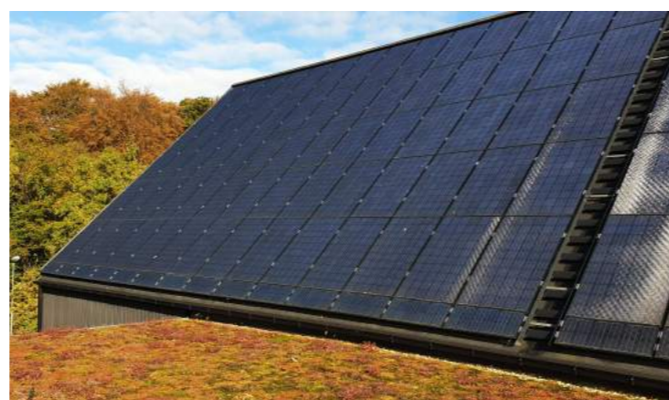
Väla gård, Helsingborg - solceller på tak
