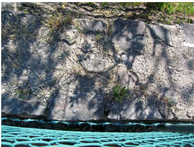
Murens ovsida med vittrat bruk och beväxning.
