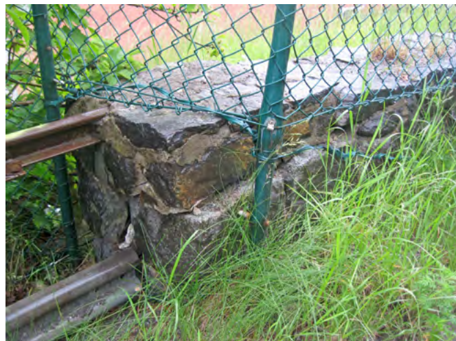
Östra änden på aktuell murdel. Förskjutning, troligen orsakad av påkörning.
