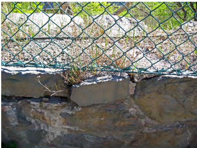
Lossnad, förskjuten sten i murens krön. Beväxning i murens ovsida
