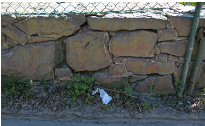
Del av muren mot Kvarnholmsvägen. Bruket i fogarna har till stor del vittrat bort
