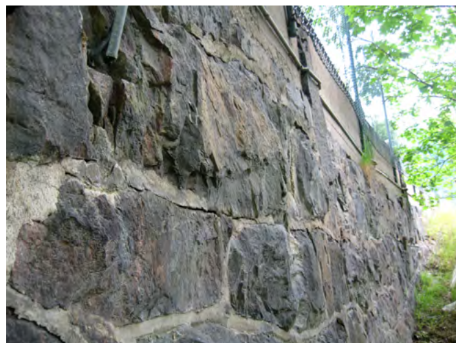
Horisontell spricka i muren.
