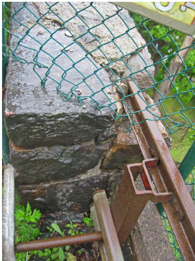
Västra änden på murdel som ska bevaras. Räcke av räls avlägsnas och ny krönsten läggs in.
