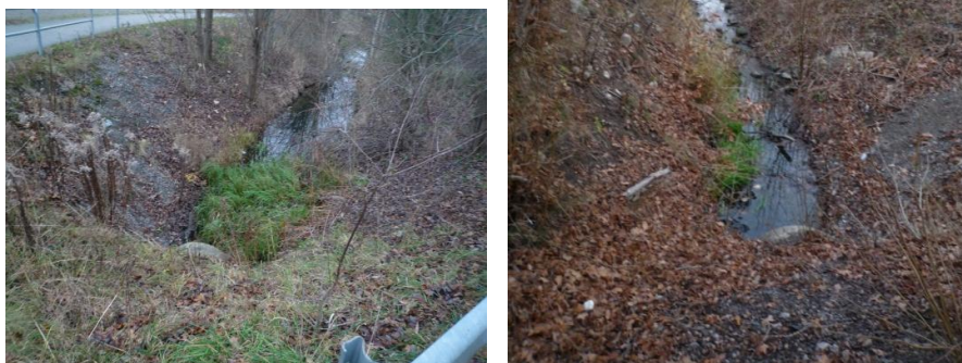
Figur 2-7 Inlopp och utlopp till kulvert under Kompassvägen.
