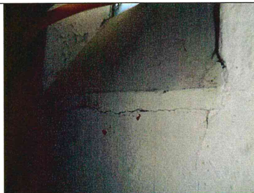
Bild 8. Spricka i grund under källarfönster.
