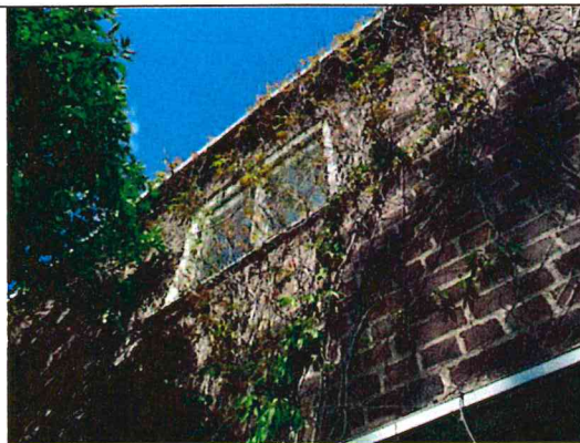
Bild 6. Vildvin västra fasaden.
