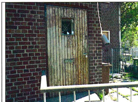
Bild 9. Dörr med flagnande lack.
