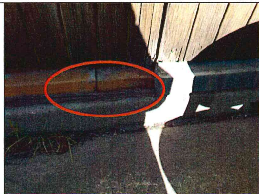
Bild 24. Risk för att det finns PCB i fog.
