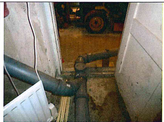
Bild 22. Nya avloppsrör av plast. Rören ligger på golvet och är kopplad till det kommunala systemet via garaget genom garageportar. Installationen förefaller högst provisorisk.
