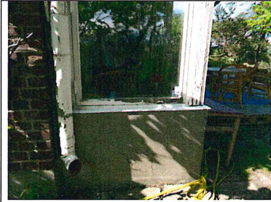
Bild 11. Fönster i dålig kondition.
