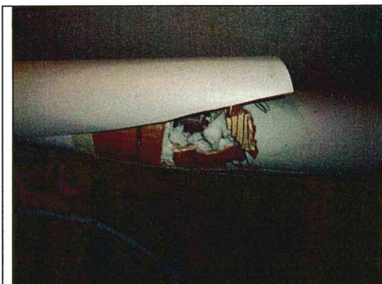
Bild 25. Plastskålar som verkar vara lagda på gammal isolering. Kan innehålla asbest.
