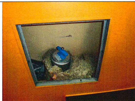
Bild 18. Ventilationskanal i köket
