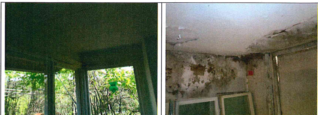
Bild 1. Fuktskada i rum under balkongen på byggnadens östra fasad.
