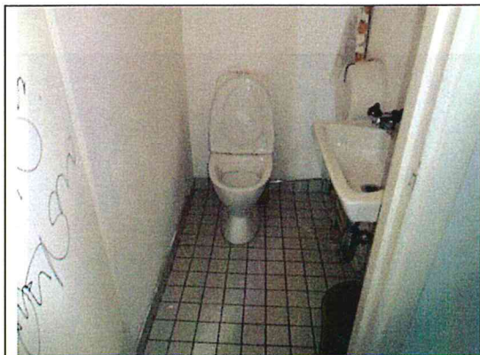
Bild 15. Toalettgolv som kan innehålla asbest.
