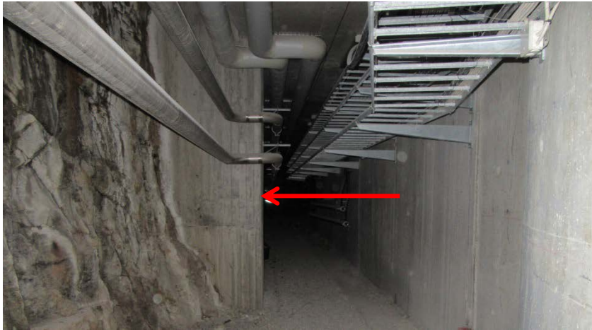
BILD 1. Nedre del av en kontrefor (pil) i frischaktet.
