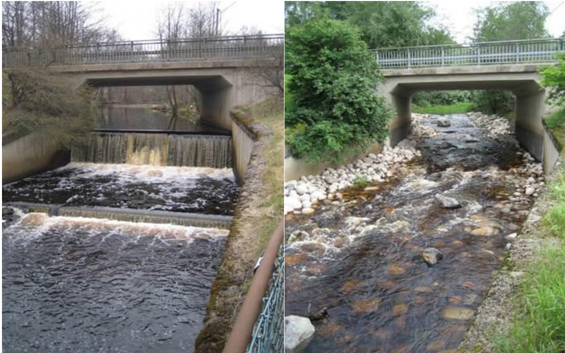
Figur 4.3. Exempel på utrivning av tröskel samt bottenuppbyggnad och biotopvård av åfåra vid bro över Imälven, Karlskoga kommun. Norconsult 2013.
