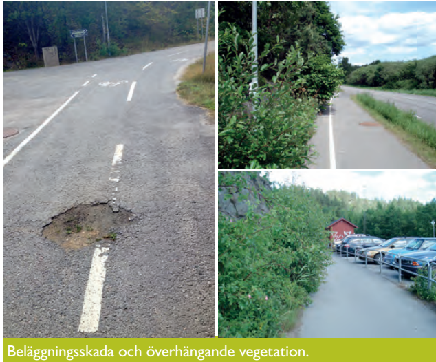
Beläggningsskada och överhängande vegetation.
