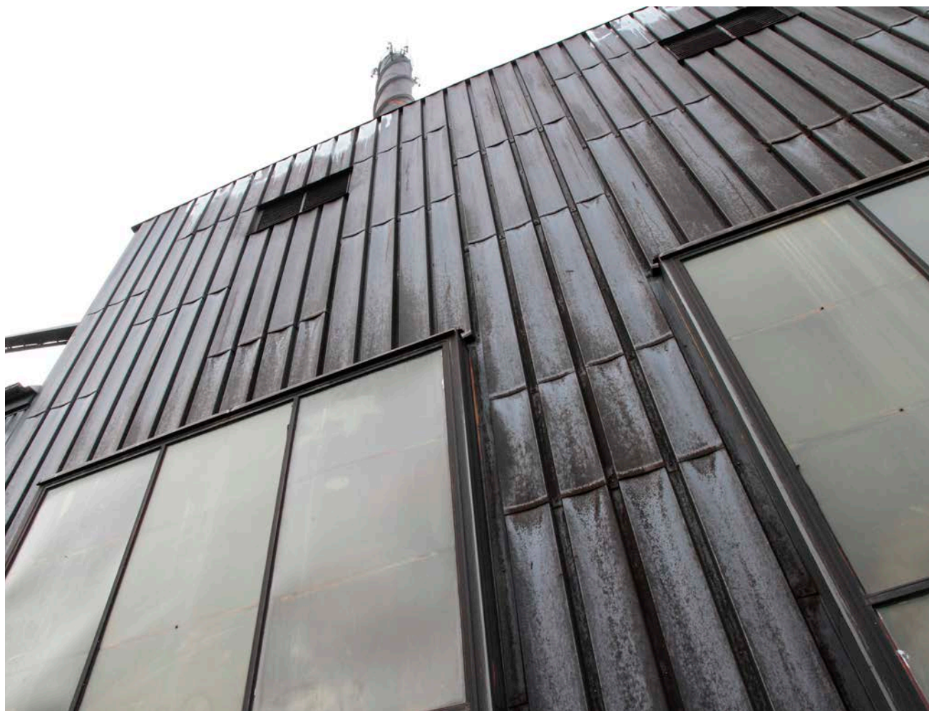
Panncentralen är centralt placerad och skorstenen syns på långt håll. Byggnaden har en robust karaktär med fasader och skorsten i cortenplåt.
