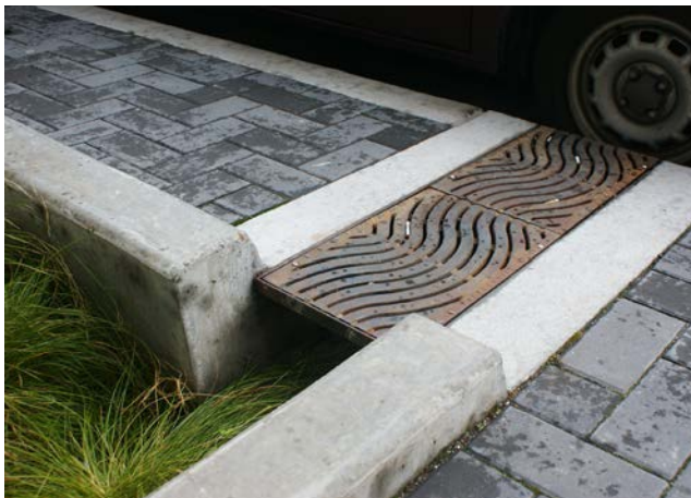
Referensbild, SWECO, dagvattenhantering, vattenränna
