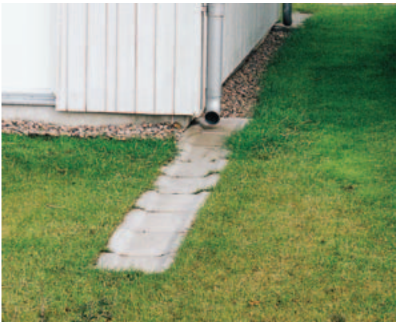
Bild 3. Detaljbild av stuprörsutkastare. En långsiktigt hållbar dagvattenhantering, 2004.
