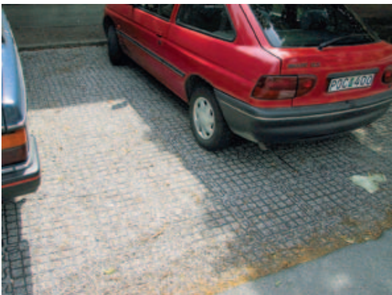
Bild 4. Parkeringsyta med singel som stabili- serats med rasternät av polyetenplast. En långsiktigt hållbar dagvattenhantering, 2004.
