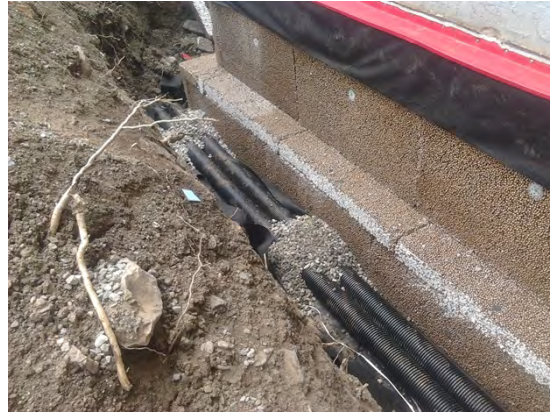
Bild 3. Dubbladräneringsrör runt huset
