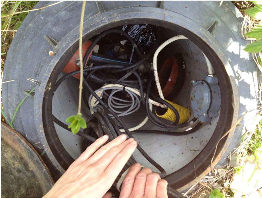
Bild C. Dräneringsbrunn med tillrinningen från höger och utloppet till vänster, mot gatan.
