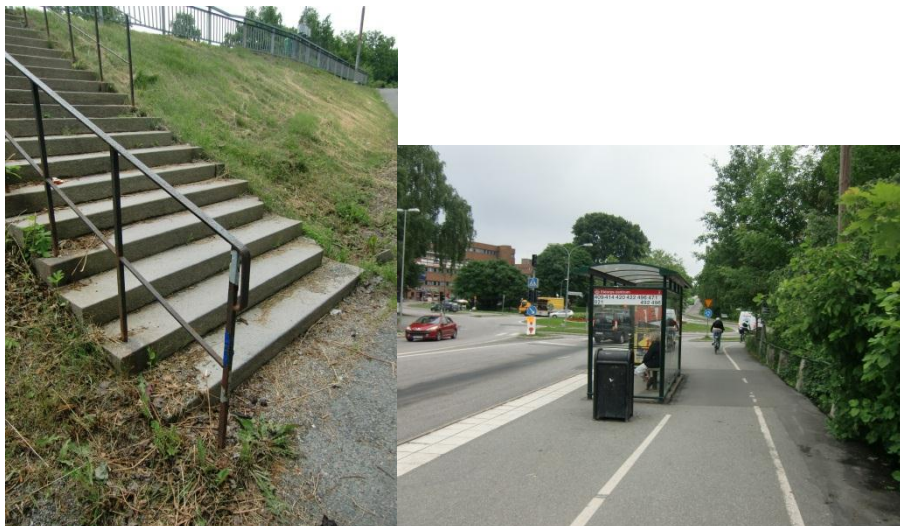
Figur 10. Trappräcke, punkt 25 tv. och busshållplats vid cirkulation vid Eknäs, punkt 28-30 t.h. (Foto: Sweco)
