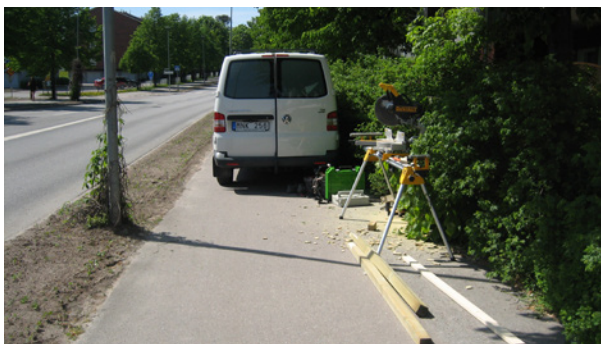
Ofta används cykelbanan som parkering eller upplag för material i samband med vägarbeten.
