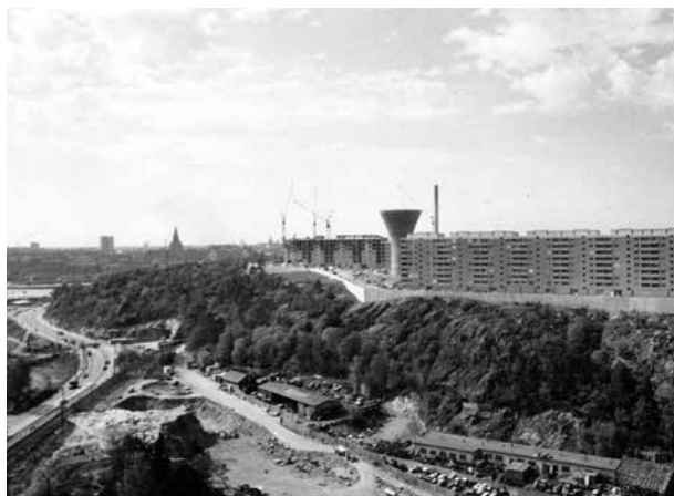
Bebyggelsen på Henriksdalsberget närmar sig sin fullbordan. Nedan i bild har arbetarna börjat med Värmdöleden.
