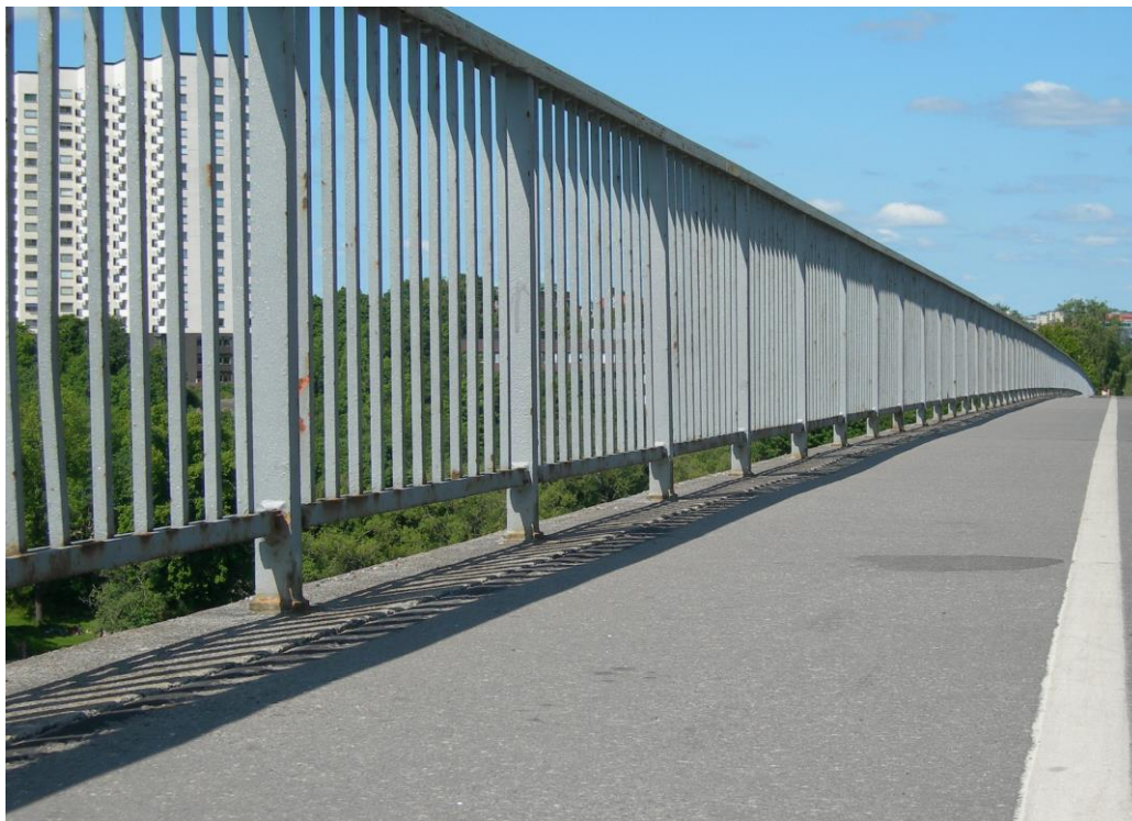
Foto 1. Kantbalk med räcke. Överytan skyddas inte mot fukt och vägsalt av ett tätskikt. De flesta kantbalkar ligger högre än vägbeläggningen. Om de inte gör det så brukar man åtgärda detta då en bro renoveras.
