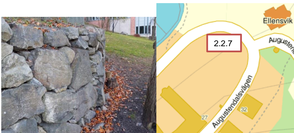
Bild 9. Stenmur 2, pågående ras och förskjutning
