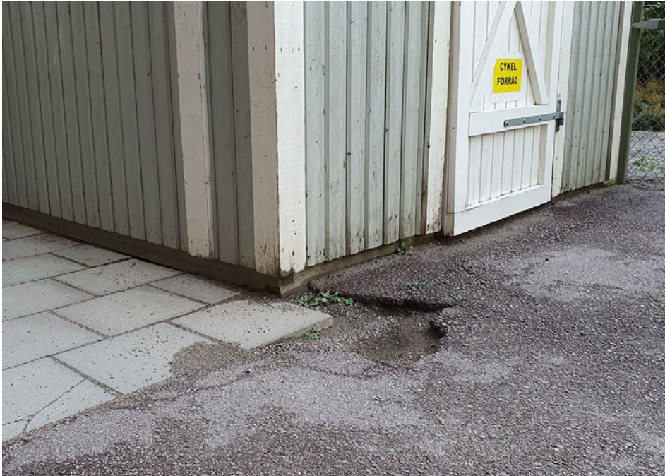
Hål i asfalt.
