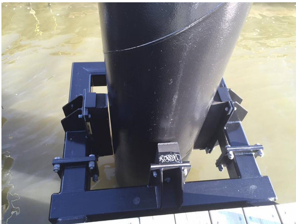
Figur 1. Exempel på påle och pålkrage. Foto: Göteborgs Stad
