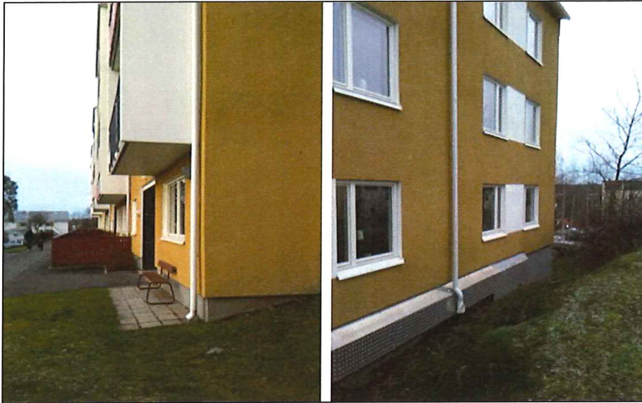
Figur 4. Stuprör med utkastare samt stuprör som leder ner till marken
