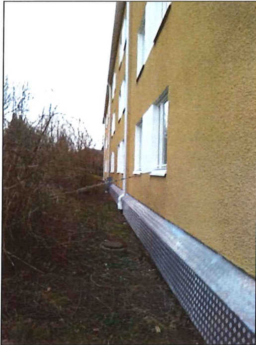
Figur 14. Området norr om befintlig byggnad som enligt Nacka kommuns skyfallsanalys kan drabbas av stående vatten vid ett 100-årsregn (Foto: Norconsult)
